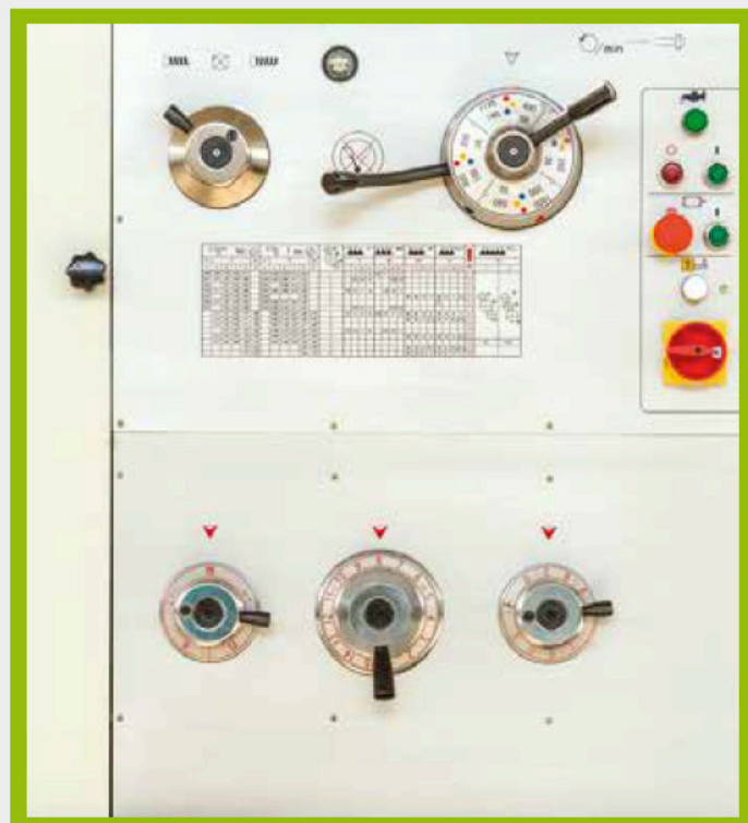
particolare quadro comandi
